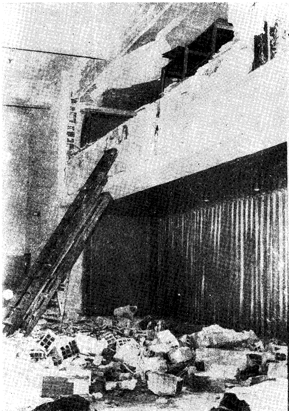
El "laboratorio" donde se produjo la explosión visto desde el hall de entrada a la sala de proyecciones.
