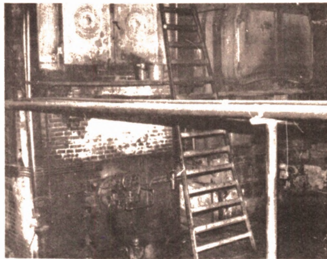
Esta es la caldera de vapor que, por vejez, sufrió desperfectos tales que seguramente la dejarán fuera de servicio por mucho tiempo, impidiendo la esterilización de elementos indispensables del hospital.
